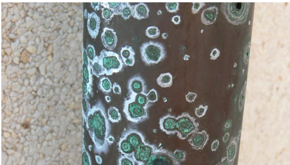
Figura 1. Corrosió d'una canalització pluvial de coure. El tub s'ha perforat i al voltant de cada forat hi ha una aurèola verdosa prima i una crosta blava clara més gruixuda. L'aigua de la pluja ha lixiviat una part d'aquesta crosta blava, que era molt més gruixuda quan es va estudiar la seva composició.
